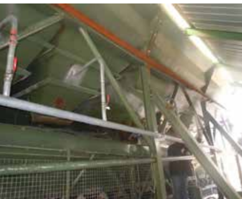
Injection vapeur dans la base des trémies
