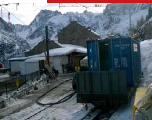
Centrale mobile en location en haut du train du Montanvers
